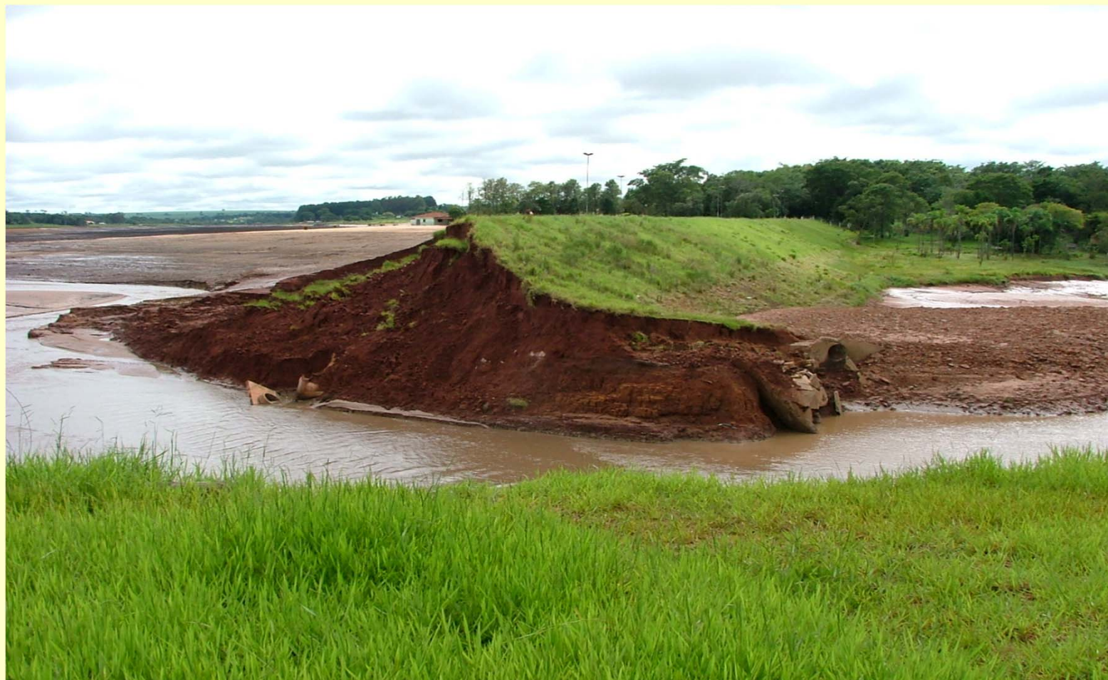
Vista de jusante, da O.D. após a ruptura.
