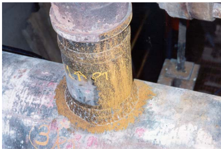
Figura 18.1- Tubulação externa à caldeira: observe a diferença no estágio de corrosão entre a região onde havia água no isolamento e a região seca.
