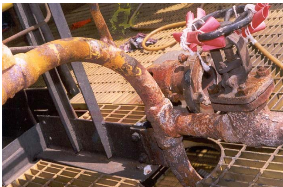
Figura 18.4 - corrosão em Linha Auxiliar
