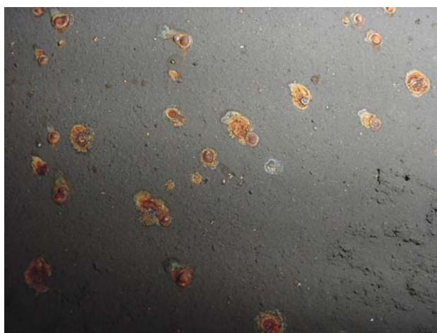
Figura 18.3: Pites de corrosão na parede interna de um Coletor de Superaquecedor Final. Estes pites reduzem a seção resistente do componente, podendo levá-lo a falhar em serviço.
