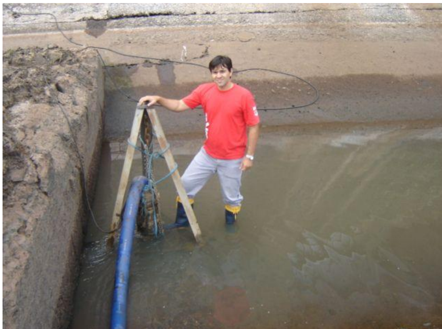
Bomba de para retirar a água da estrutura anterior ao “salto esqui”.
